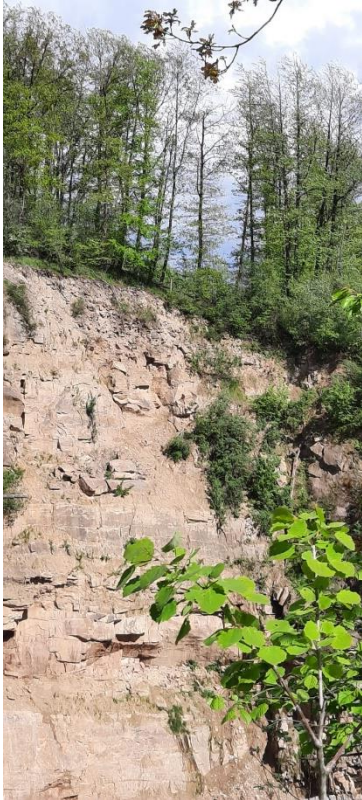
Abbildung 14 Abbruchhang Ort: Steinbruch Lindlar Datum: 24.05.2021
